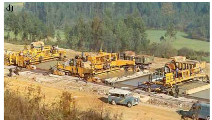
Figura 2: Pavimento de hormigón armado continuo de la autopista "Y Asturiana" en Asturias, España, a) periódico ABC de Madrid, 14 de febrero de 1976, b) panorámica de parte de la Autopista (Díaz, 2010), c) armaduras y d) colocación del hormigón
