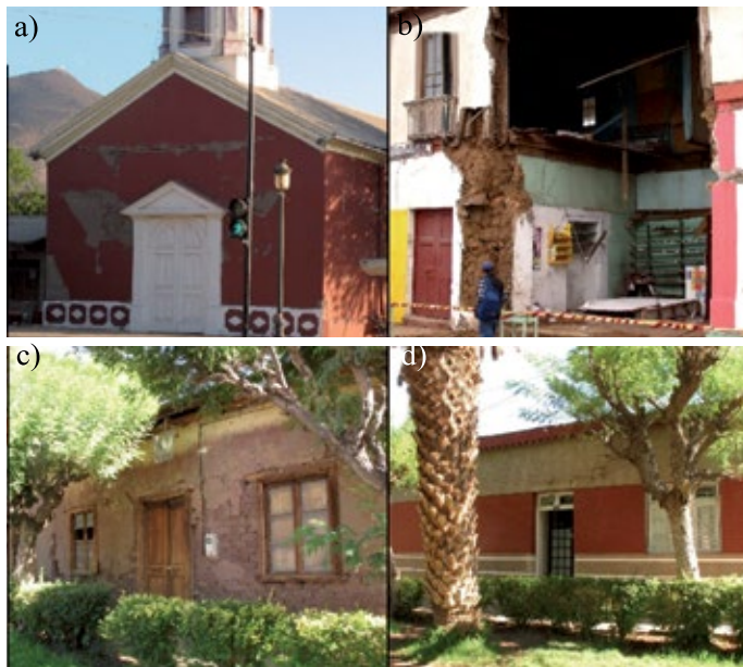
Figura 4: Fotografías de estructuras dañadas en localidades de la Región de Coquimbo tomadas en enero de 2016. a) Iglesia de Monte Patria, b) derrumbe de vivienda en Illapel, c) y d) viviendas contiguas en Combarbalá de adobe, con y sin daños, respectivamente.
