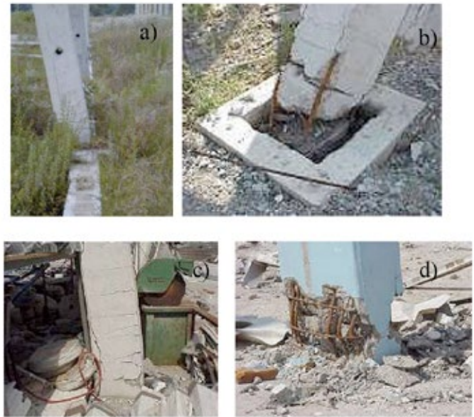
Figura 1: Patrones de daños sísmicos presentes en columnas prefabricadas industriales de hormigón armado en Turquía; a) daño concentrado por rótula flexural en base de columna (Posada y Wood, 2002), b) daño concentrado en base de columna con fundación del tipo zócalo, c) daño por rótula flexural distribuida en 800 mm de altura de columna y d) daño severo por rótula flexural concentrada en base de columna (Saatcioglu et al. , 2001)
