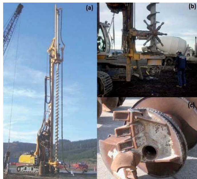
Figura 2: a) Ejecución pilote CFA de 18 m (Pilotes Terratest, 2009), b) limpieza de hélice (Pilotes Terratest, 2009) y c) punto de descarga de hormigón en el fondo (Brown et al. , 2007)
