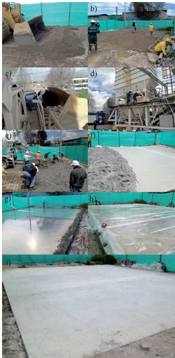
Figura 10: Imágenes del proceso constructivo de la prueba piloto, a) preparación del terreno, b) colocación de moldaje perimetral, c) descarga de cemento, d) planta de concreto, e) vertido de concreto, f) nivelado, g) piscina de saturación, h) retención de la humedad e i) estado final
