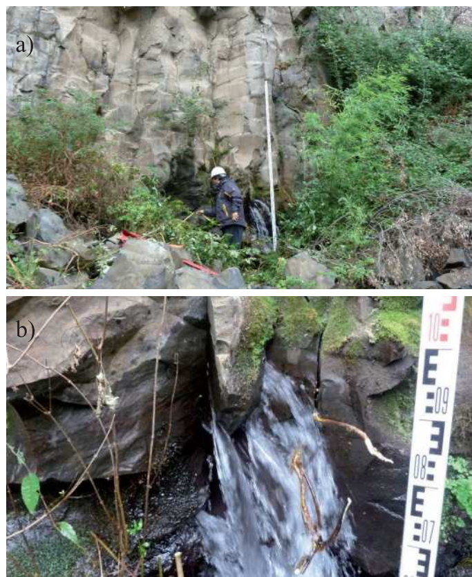
Figura 9: Vertientes que descargan al río Diguillín desde formaciones de rocas fracturadas ubicadas en el sector mostrado en la Figura 8
