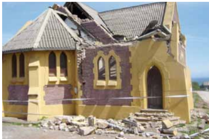
Figura 5: Vista posterior y sacristía parcialmente destruida
