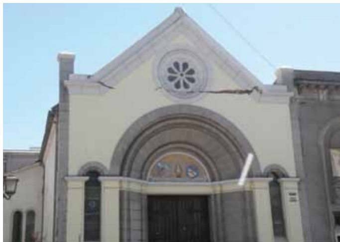
Figura 9: Vista exterior de El Sagrario mostrando daños en frontón
