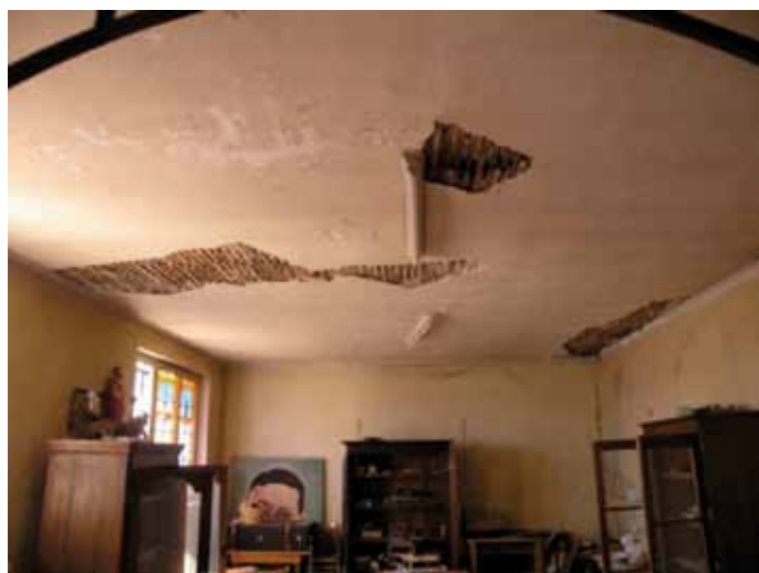
Figura 14: Vista interior de la sacristía con daños en el cielo.
