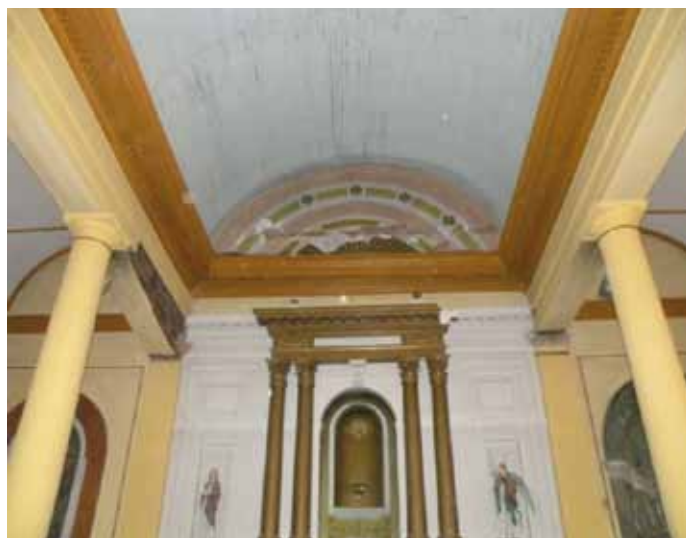
Figura 13: Vista interior y el daño en muro posterior en la parte superior de la nave central.
