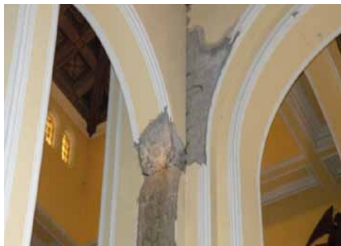
Figura 7: Daño estructural en unión de columnas
