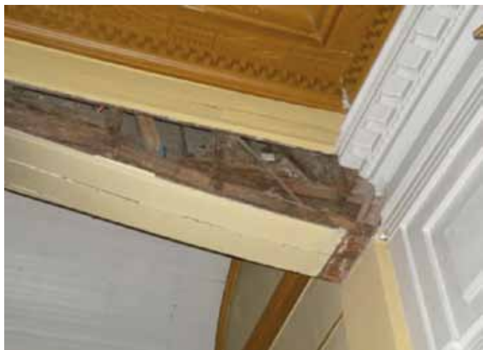
Figura 11: Estructura de techumbre con daños en elementos de madera.
