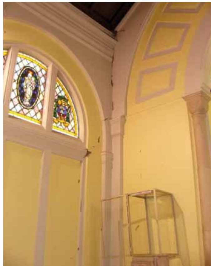
Figura 10: Vista interior con daños en esquina de muros
