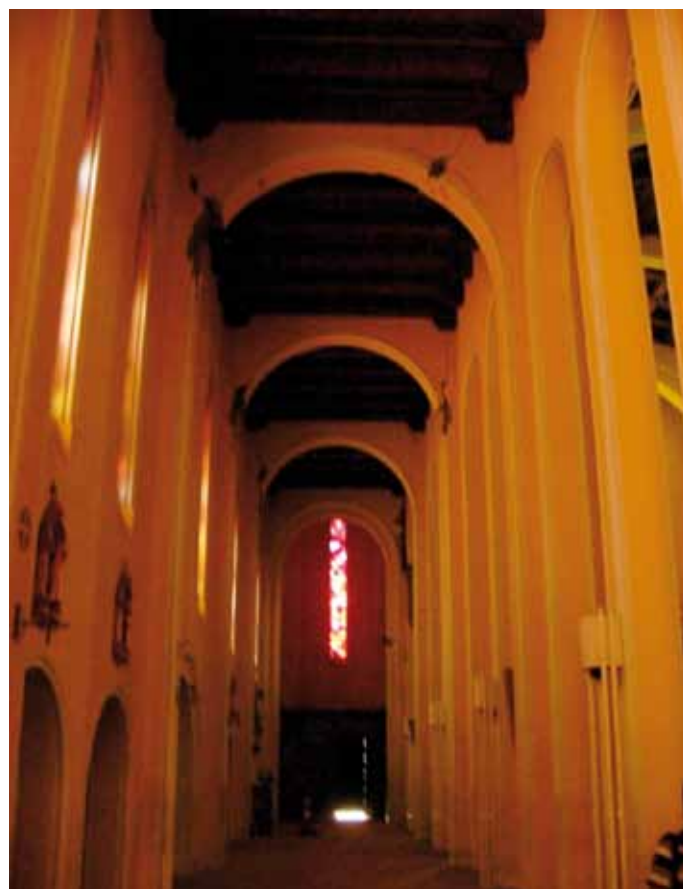
Figura 8: Vista de nave lateral con daños en vigas de arcos
