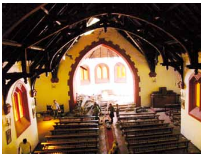
Figura 6: Vista interior de la estructura de techo y muro posterior parcialmente dañado.
