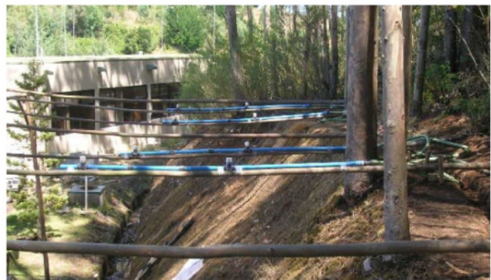
Foto 11: Estructura de soporte para el sistema de lluvia
